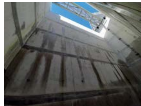
Obrázek 3: Průsaky do sdruženého objektu během ověřovacího provozu SN Jelení
