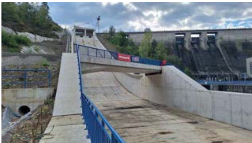
Obrázek 8: Pohled na hotový skluz bezpečnostního přelivu
