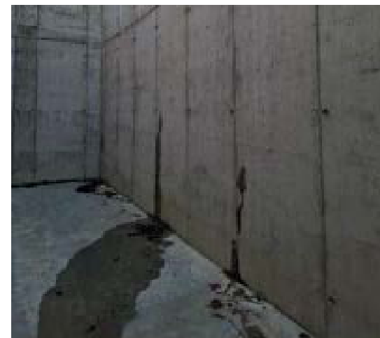
Obrázek 6: Průsaky stěnami sruženého objektu VD Baška
