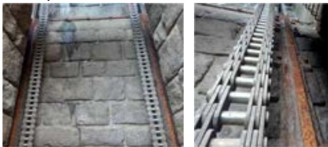
Obrázek 1: Detail gallova řetězu s pojezdovou kolejničí v roce 2021
