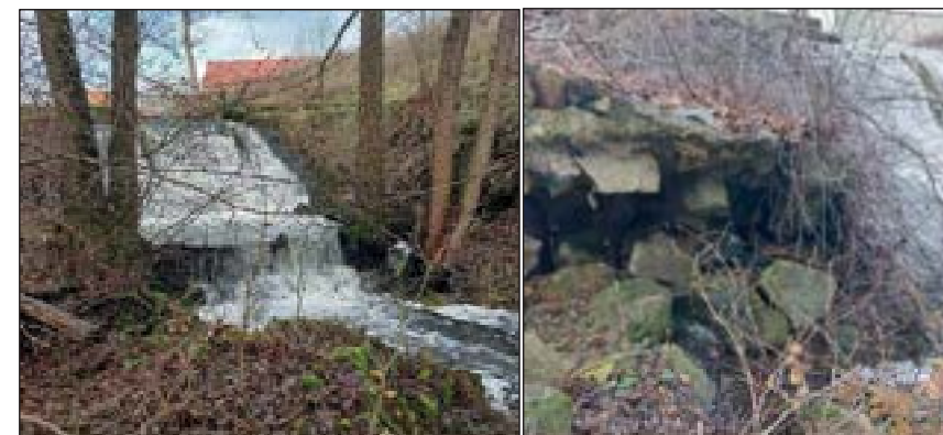
Obrázek 2: pohled proti toku na poškozenou hráz stávajícího vodního díla
