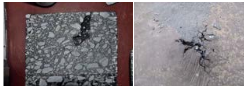
Obrázek 1: Příklad bodové poruchy AB pláště - puchýřku. Vlevo - stádium vývoje uvnitř pláště, vpravo - pokročilé stádium s progresí poruchy na povrch AB pláště
