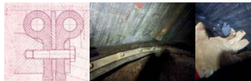
Obrázek 5: Detail pryžového těsnění mezi jehlou a pevnou válcovou plochou střední části uzávěru – vlevo původní dokumentace, střed a vpravo poškozený stav pryží před opravou
