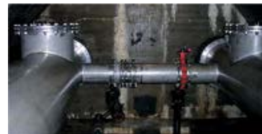
Obrázek 3: VD Opatovice, nové nerezové potrubí spodních vpustí, červen 2004
