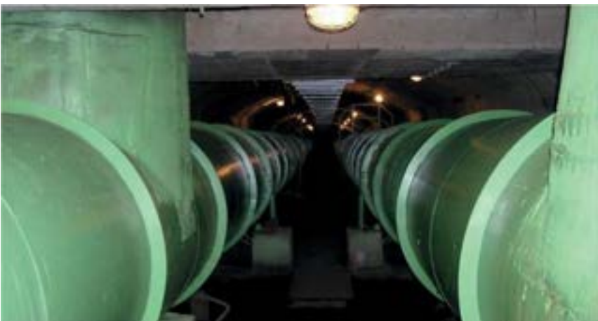
Obrázok 4: Potrubie dnového výpustu v Lúčkach (zdroj: Etapová správa o dohľade, 2024)
