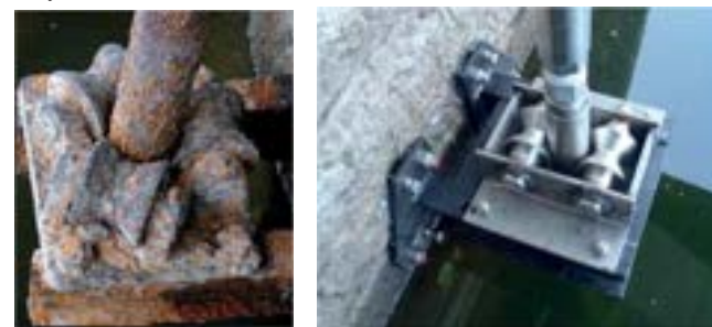
Obrázek 2: Táhla a detail vodičích roln (vlevo původní stav, vpravo po výměně) v roce 2016
