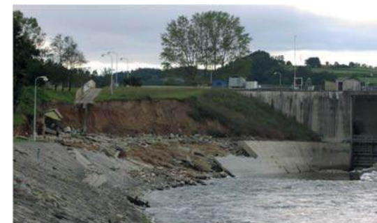
Obrázek 3: Rozsah poškození pravého břehu po průchodu povodně 2002
