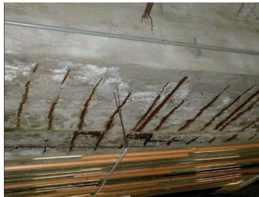
Obrázek 3: Plošně odpadlá krycí vrstva a silná koroze betonářské výztuže na spodním lici příčného trámu nosné konstrukce
