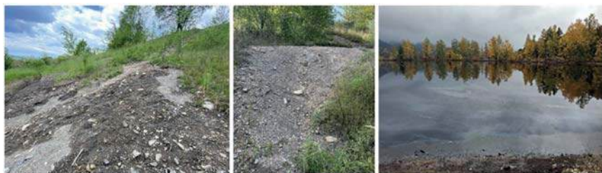
Obrázok 2: Predajná I – porušený svah hrádze a priesaky – r. 2021 (vľavo) / súčasný stav (v strede), pohľad na hladinu (vpravo)
