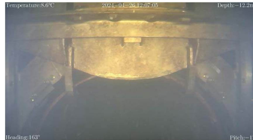
Obrázek 7: Spodní výpust s tabulovým uzávěrem, vrchní část
