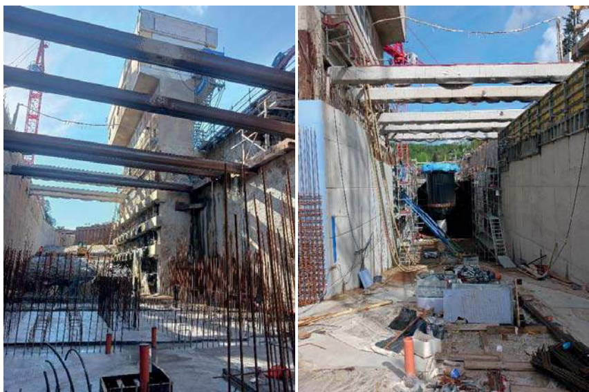
Obrázek 5: Pohled na nátok do MVE Klecany II (09/25), pohled na technologickou část nové MVE Klecany II (05/26)
