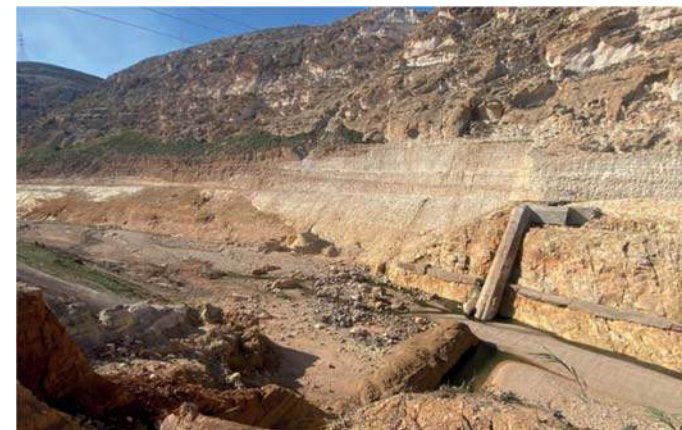
Obrázek 5: Profil hráze přehrady Monsour po její destrukci [2]
