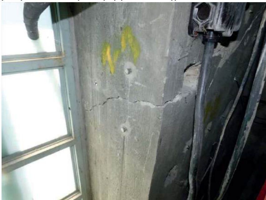
Obrázek 2: Šikmá trhlina na lici povodní stěny strojovny
