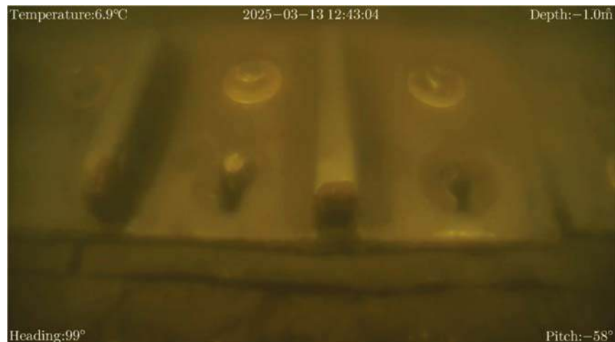
Obrázek 5: Chybějící spojovací materiál na nosiči těsnění
