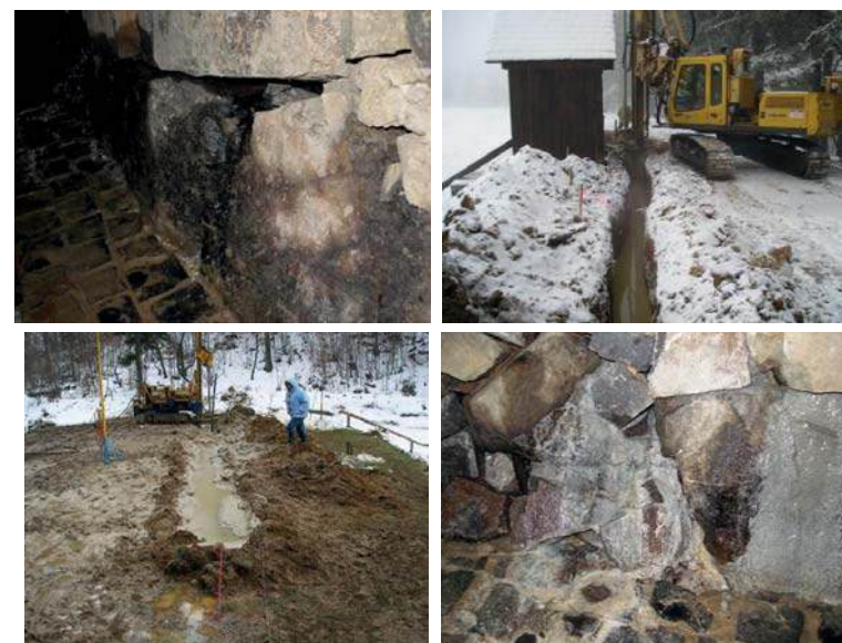
Obrázok 7: Vodná stavba Bakomi – prejavy priesakov v telese hrádze a realizácia injektážnych prác zameraných na zvýšenie filtračnej stability hrádzového telesa, 2007. (Zdroj: archív SVP, š.p.)
