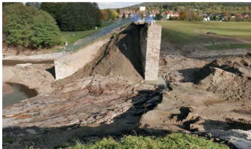
Přehrada Stronie Śląskie po porušení, pohled z návodní strany
