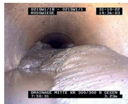
Zanesený drenážní systém před opravou
