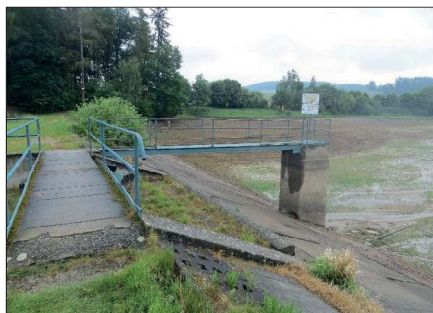
Obrázek 1: Původní stav nádrže po vypuštění.
