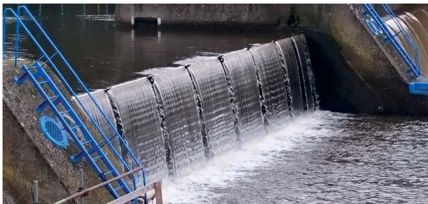
Obrázek 4: Typický projev vibrací jezové klapky, řasení přepadového paprsku a vlnění na horní hladině u přelivné hrany.
