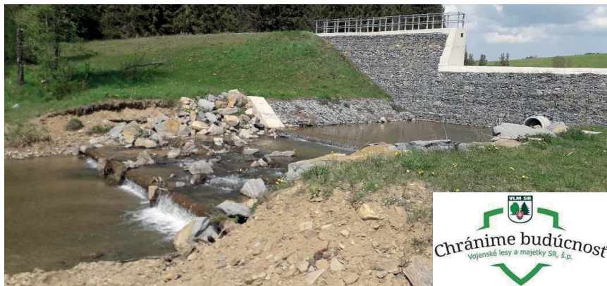
Obrázok 5: Poškodenie úpravy brehov pod vývarom počas zvýšených prietokoch v toku dňa 22.09.2017
