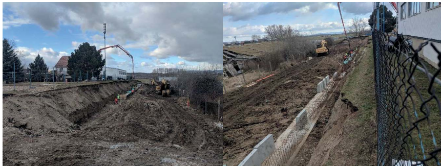
Obrázok 3: vľavo – zárez do jestvujúceho násypu; vpravo – malý lokálny zosuv v blízkosti prevádzkovej budovy.
