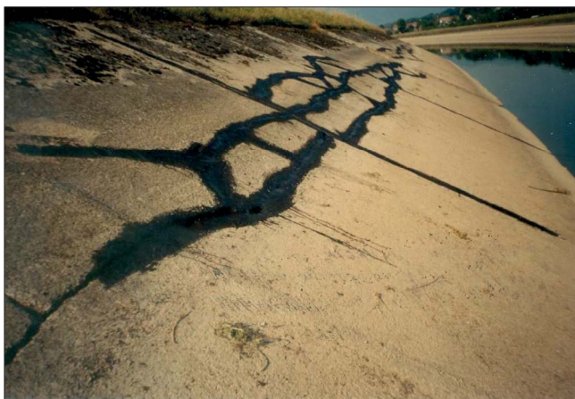
Obrázok 2: Poruchy betónového tesnenia – priestor manipulácie prevádzkových hladín.
