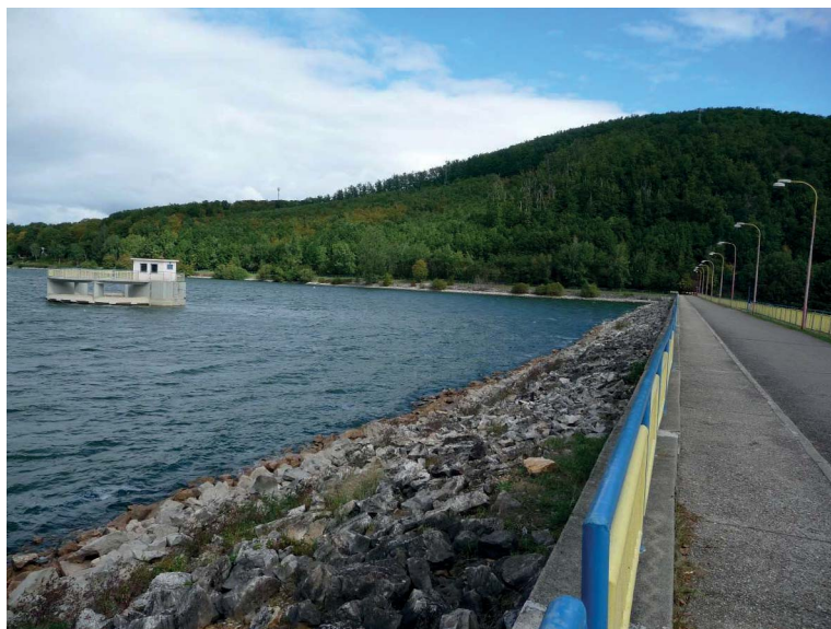
Obrázok 2: ZFO a koruna hrádzového telesa pred opravou.
