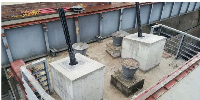
Obrázok 3: Foto s tromi starými kotvami a dvomi novými, ešte nefunkčnými kotvami (09/2019)
