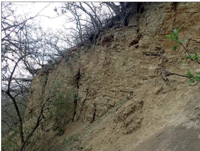
Obrázek 10: Stěna abrazního srubu při západním okraji sesuvu u osady Oáza s výraznými otevřenými tahovými trhlinami.
